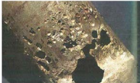
Figure 8 : Exemple de corrosion bactérienne par les BSR sur un tube en inox
