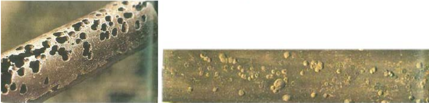
Figure 7 : Exemple de corrosion bactérienne par les BSR sur un tube en aluminium
