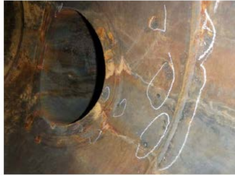
Figure 4 : zones avec dégradation interne boîte
