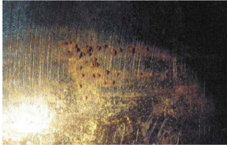
Figure 5 : dégradation en interne calandre
